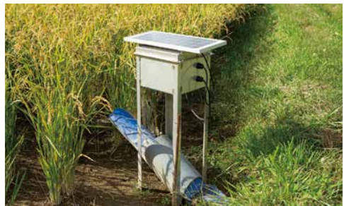
03 農匠自動水門はバッテリーが内蔵され、上部のソーラーパネルで充電。ボックスの下には水路とつながったホースがあり、ホースが上下して給水・止水します。遠隔操作はできませんが安価に導入できます。
